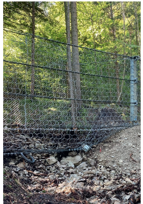
Abb. 26: Eine neu errichtete Seilsperre oberhalb der Staatsstraße 2089, nördlich von Oberaudorf schützt Straßenverkehrsteilnehmende vor Muren, die im Zusammenhang mit Stark- und Dauerniederschlagsereignissen aktiv werden.
